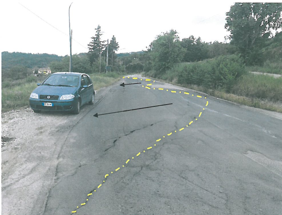
FOTO 2 - Area interessata dal dissesto.
