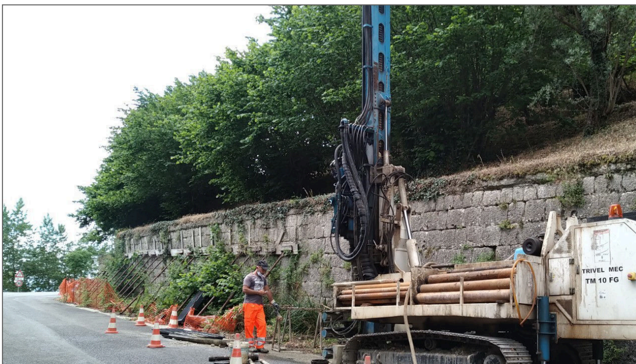
Fig. 7 – Tratto del muro in oggetto, puntellato in seguito a evidente inclinazione.
